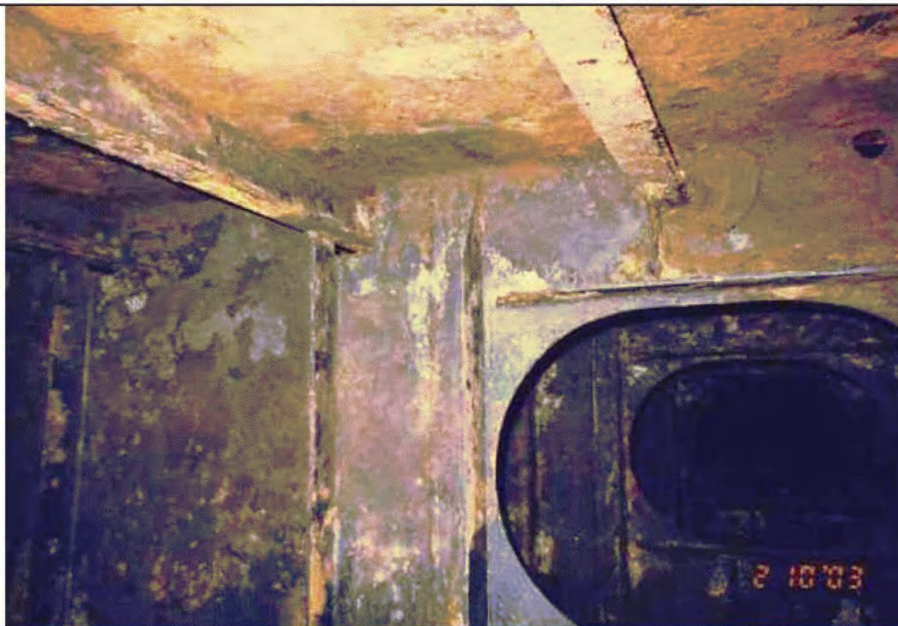
ПЛОХОЕ СОСТОЯНИЕ ПОКРЫТИЯ
