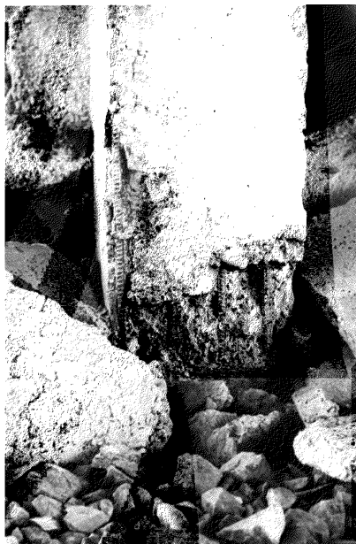
Рисунок М.1 – Повреждение стойки опоры автодорожного путепровода при землетрясении силой 9 баллов
