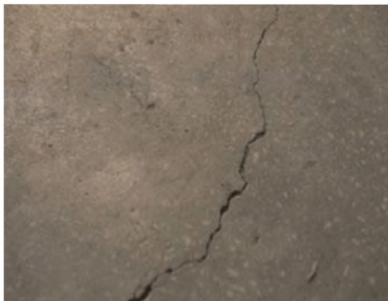
Рисунок 1 – Подвижная трещина. Общий вид
