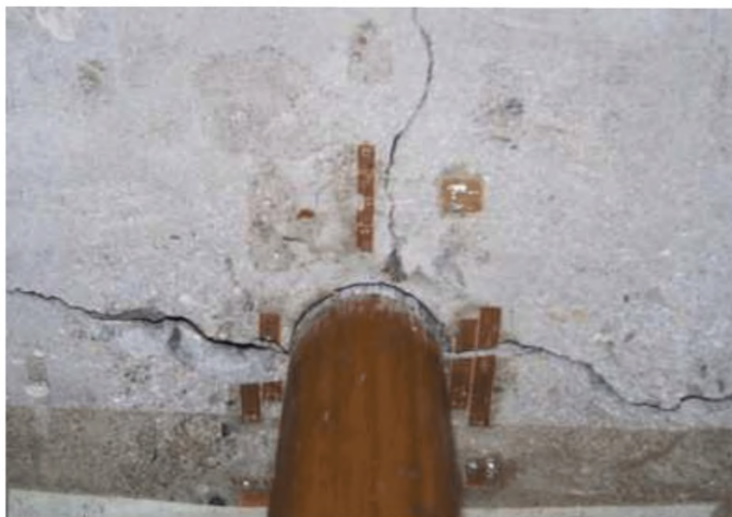
Рисунок 10– Развитие трещин в бетоне в окрестности стального штыря
